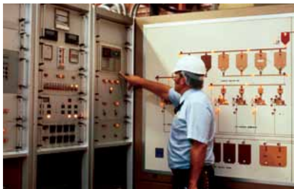
Panel de control basado en un Simatic S5 135U en una planta cementera
