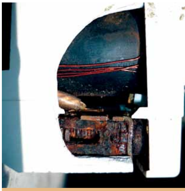
Detalle del borne dañado
