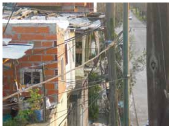
Redes aéreas precarias
