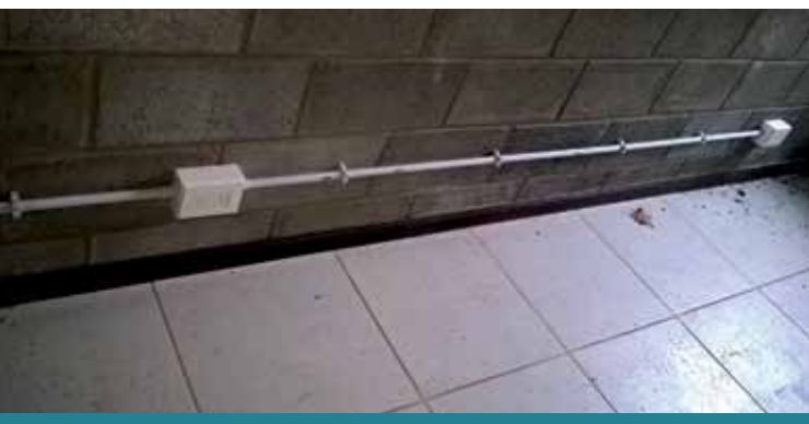
Instalación interior a la vista: no es obligatorio amurarlo todo
