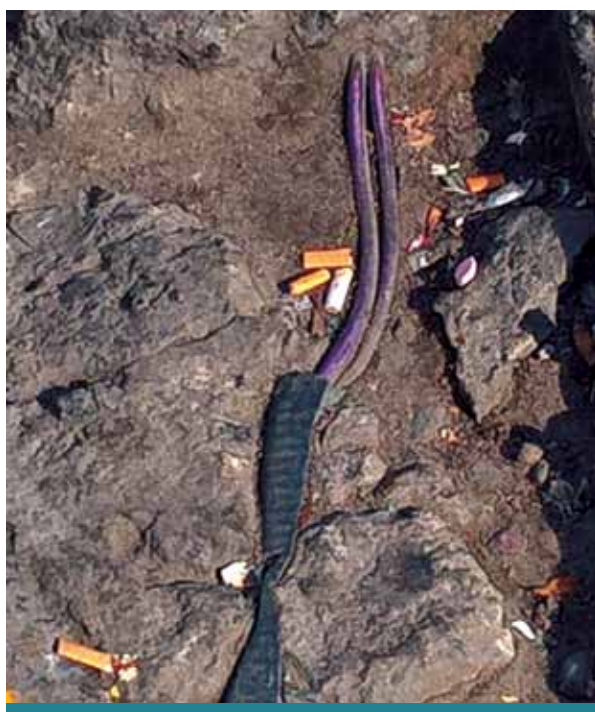
Cables subterráneos bajo el hormigón de la calzada en vías de destrucción
