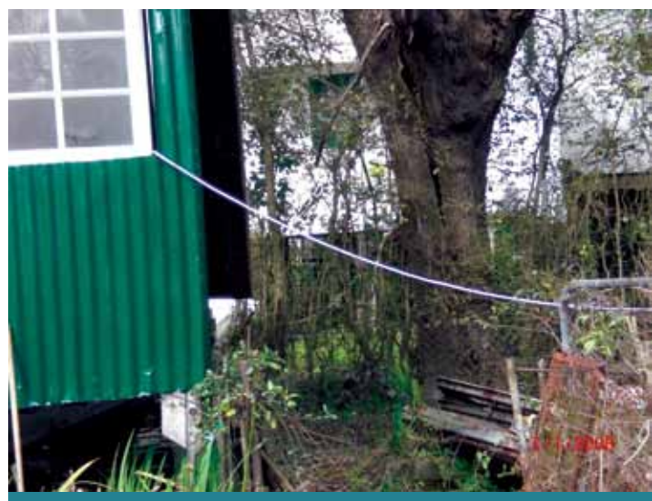
Cable para uso subterráneo, pero al vuelo
