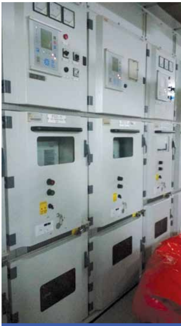
Vista de los tableros eléctricos renovados de la sala de máquinas
