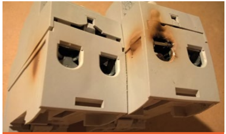
Figura 2. Interruptores diferenciales dañados por recalentamiento
