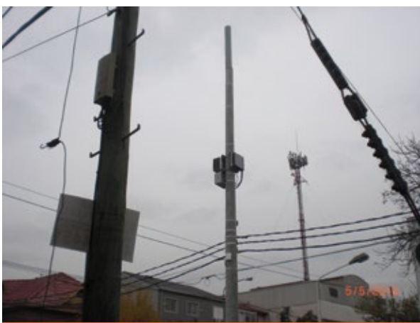
Figura 5. Líneas telefónicas seguras reemplazadas por antenas
