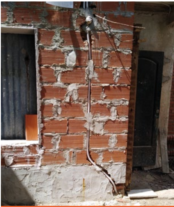
Figura 2. Canalización sinuosa expuesta a inundaciones
