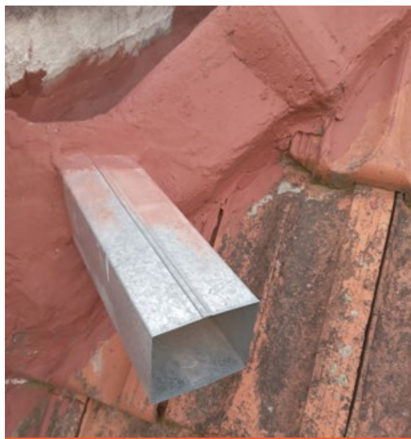
Figura 1. Desborde en canaleta existente
