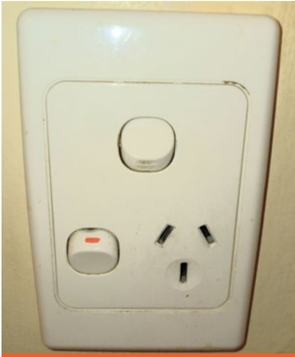
Figura 2. Toma con interruptor asociado
