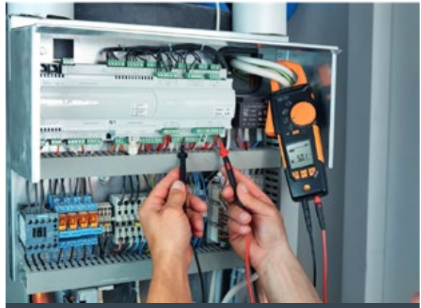
Puesta a punto de los sistemas de control y regulación energética.
