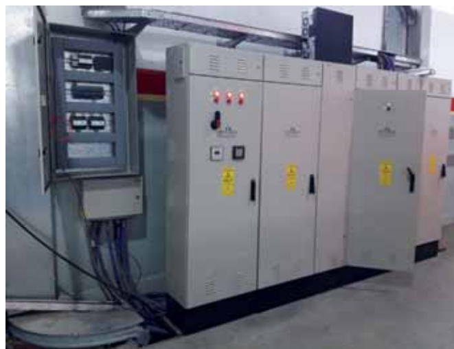
Figura 5. Tablero seccional del sistema de control DALI
