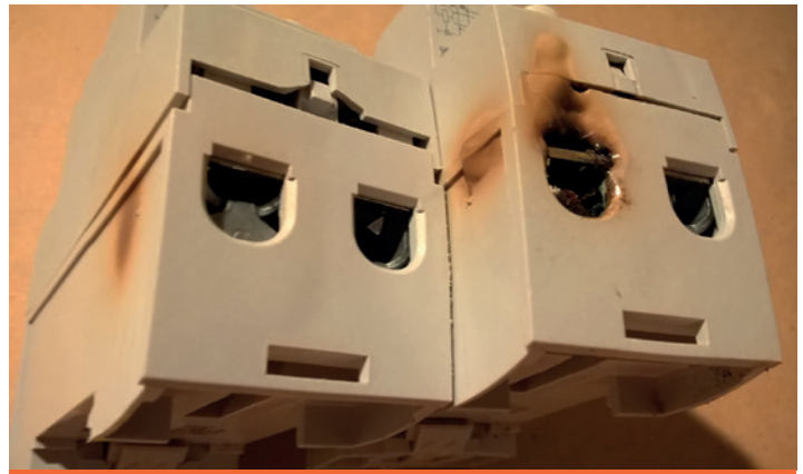
Figura 2. Interruptores diferenciales dañados por recalentamiento
