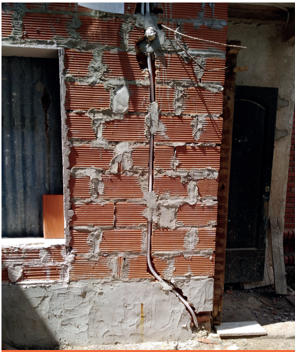
Figura 2. Canalización sinuosa expuesta a inundaciones
