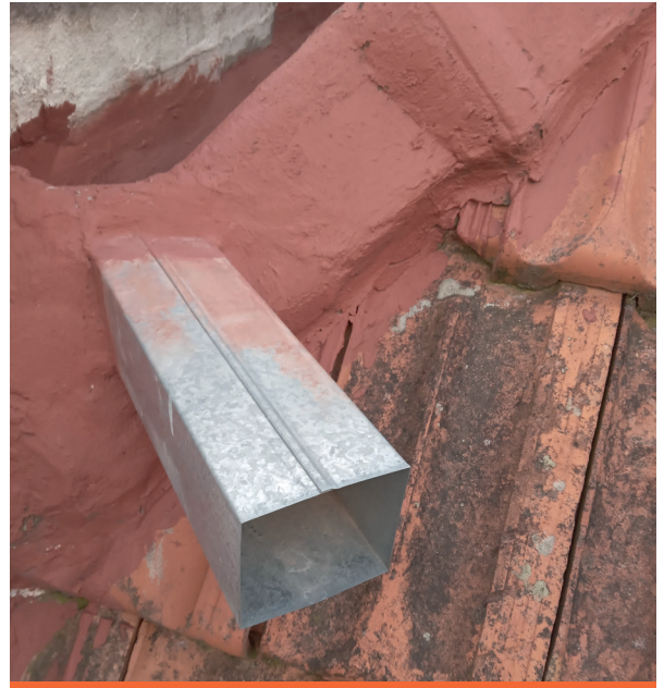
Figura 1. Desborde en canaleta existente
